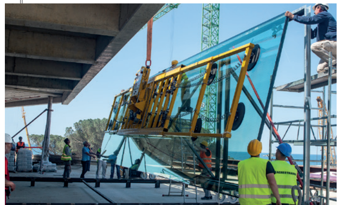
Vakuum-Sauganlage VSG 6000 KMH mit 15 m langen Scheibe
